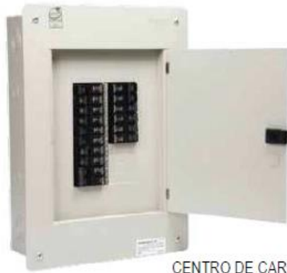
CENTRO DE CARGA
